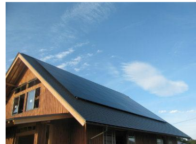
▲共有棟の大きな屋根一面に設置された7kWの太陽光発電パネル
